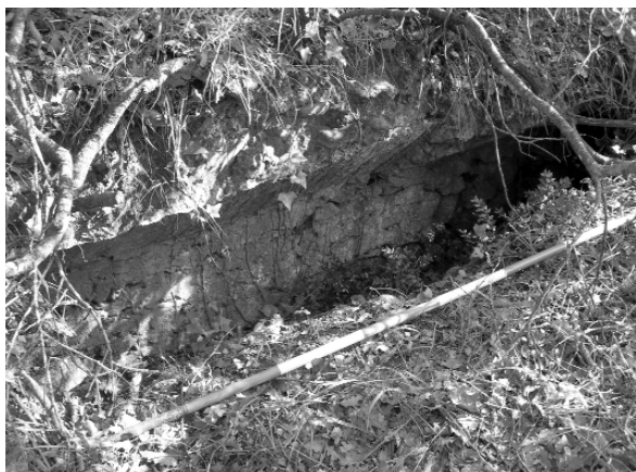
Fig. 19. La breccia nella calotta del condotto idrico.
